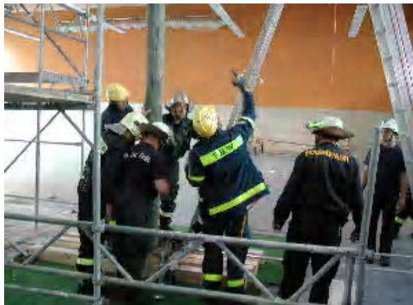
THW und Feuerwehr sichern gemeinsam die Sporthalle
